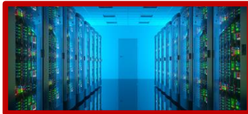
Rechenzentren – USV, Kaltgangeinhausung
